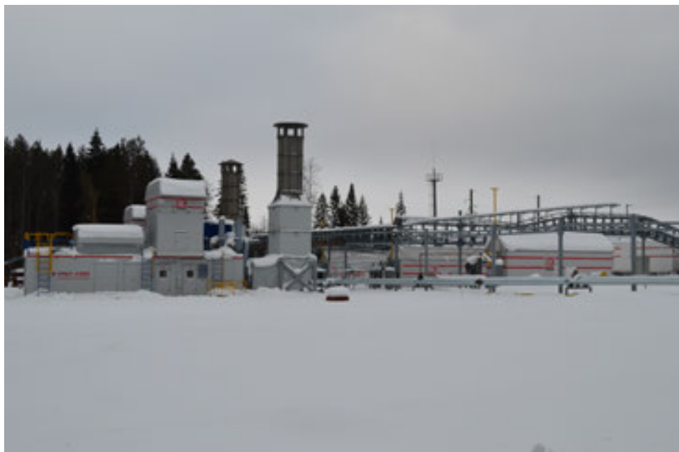
ГТЭС «Урал-4000» на Ильичевском месторождении ООО «ЛУКОЙЛ – Пермь»
