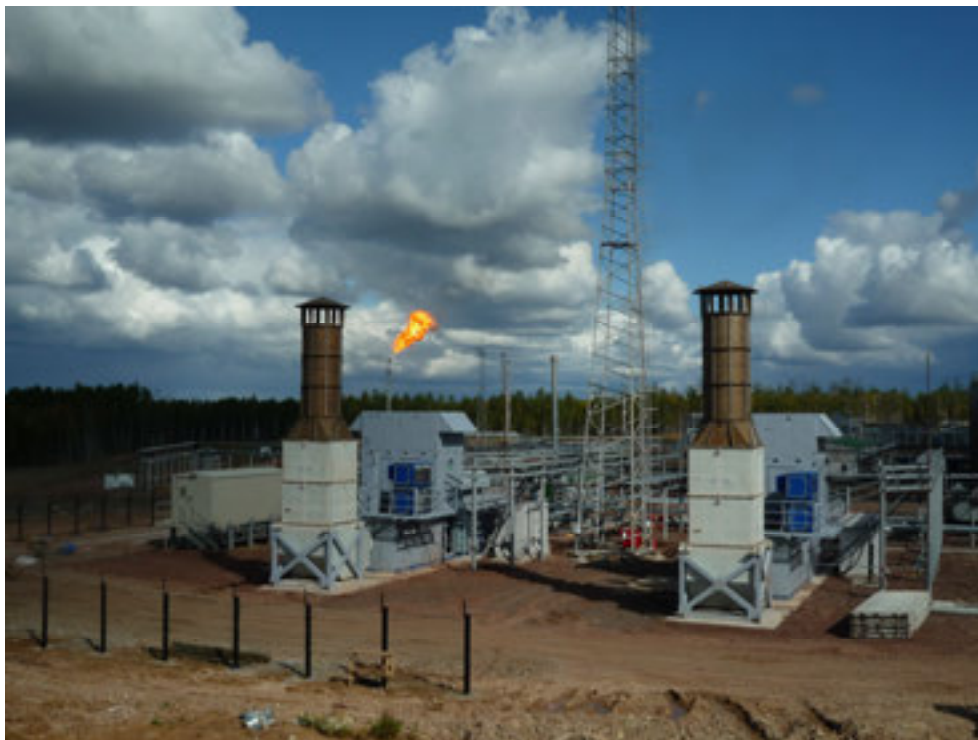
ГТЭС «Урал-6000» на Ярактинском НГКМ ООО «Иркутская нефтяная компания»
