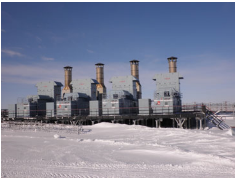
ГТЭС «Урал-6000» на Пяяхинском ГКМ ООО «ЛУКОЙЛ – Западная Сибирь»
