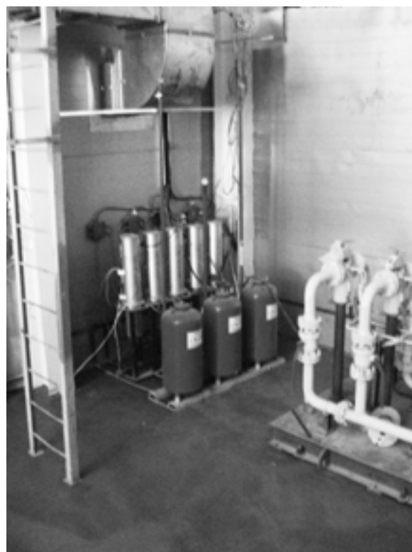
Комбинированная установка пожаротушения с аэрозольными генераторами АГАТ-2А (34 шт.) и порошковыми модулями ОПАН-100 (14 шт.), газоперекачивающего агрегата 66ГЦ-1162 АО «СибурТюменьГаз» (реализована в 2011 г.)
