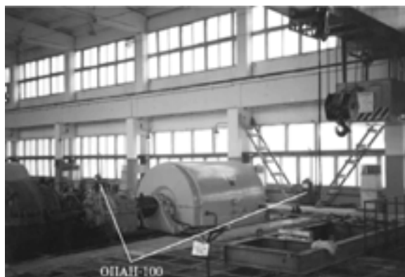
Автоматическая система противопожарной защиты компрессорного цеха завода «Пермнефтегазпереработка» (г. Пермь)
