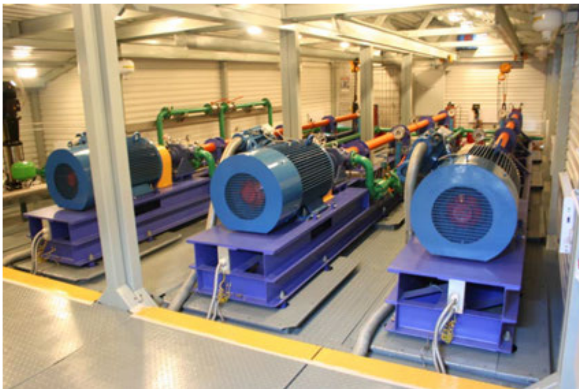
Рис. 7. Станции поддержания пластового давления
